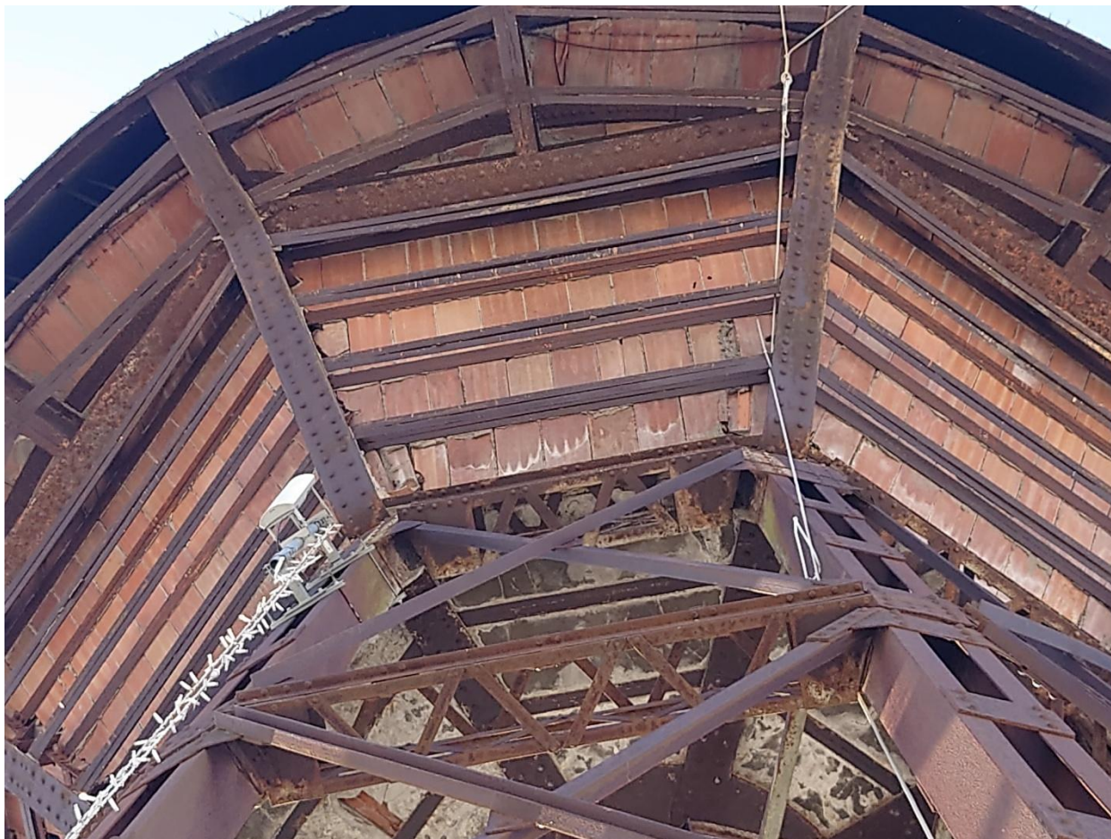
Fig. 5 – Foto intradosso serbatoio – particolare tavelle in laterizio
